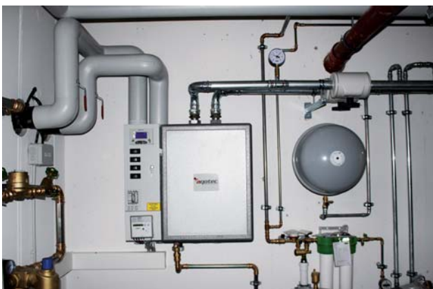
Foto: Übergabestation von Primär- zu Sekundärseite
